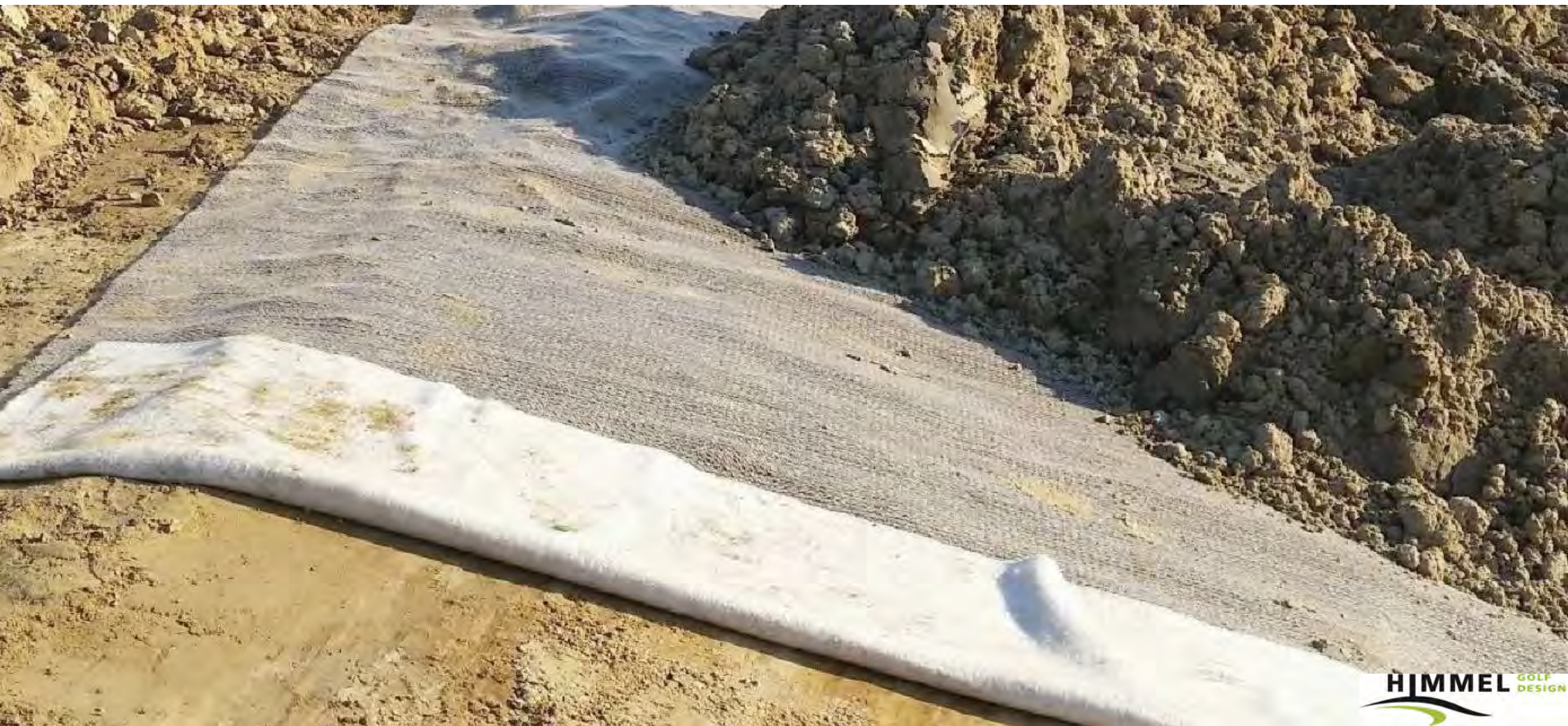
Abdichtung mit Bentonitmatten (suboptimal bei sandigem/kiesigem Untergrund)
